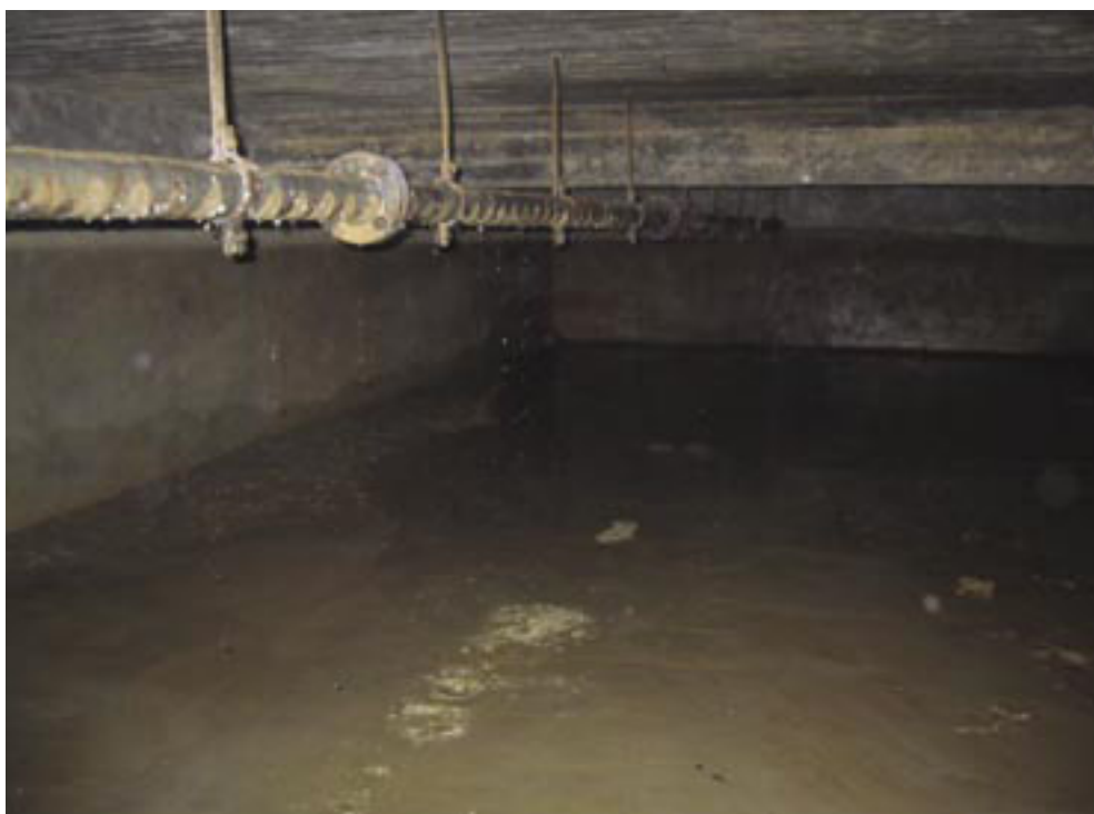
Photo 195 - Cuve de stockage de l'eau
