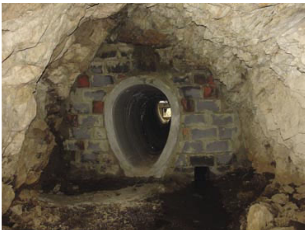
Photo 107 - Tubage de la galerie suite à un éboulement
