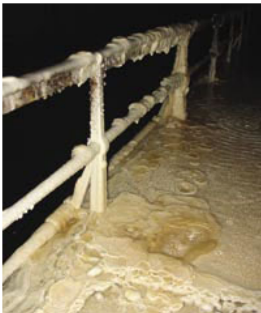
Photo 37 - Concrétions apparues sur la banquette de halage
