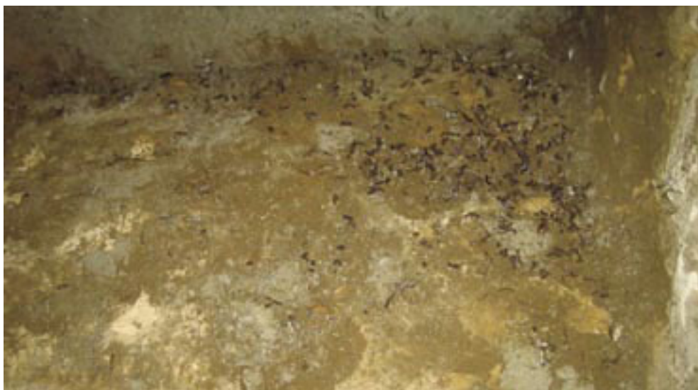
Photo 194 - Nombreuses traces de chauves-souris sur le seuil des pertuis
